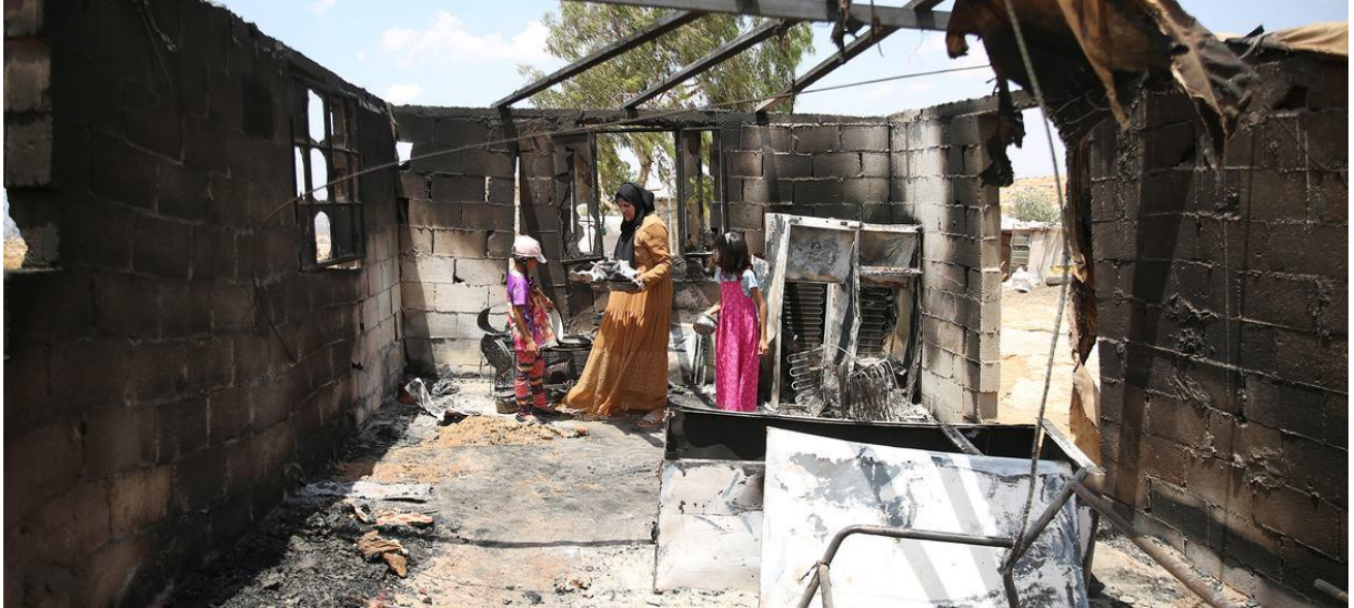
Figura 4 – Estrutura queimada e famílias entre os escombros em Gaza
